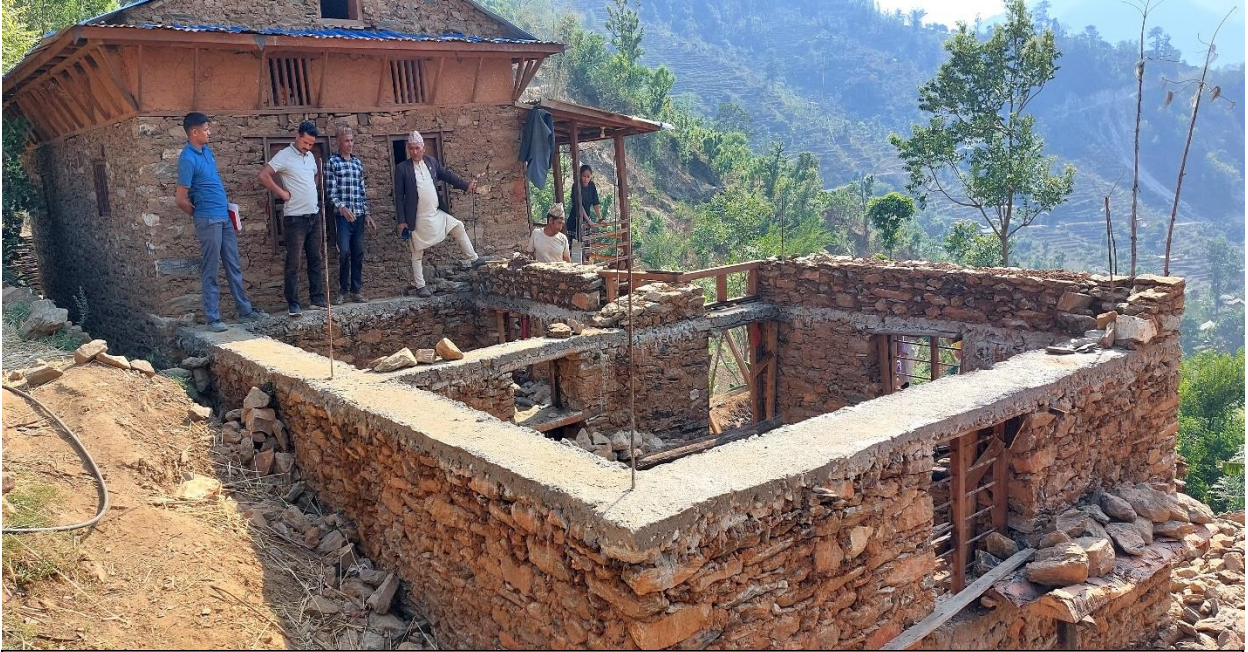
कर्णाली प्रदेश सरकारको जनता आवास कार्यक्रम अन्तर्गत छेडागाड नगरपालिका वार्ड नं. ११ मा निर्माणाधीन विपन्न घर। छेउको तयारी घर पनि विपन्नकै हो।
